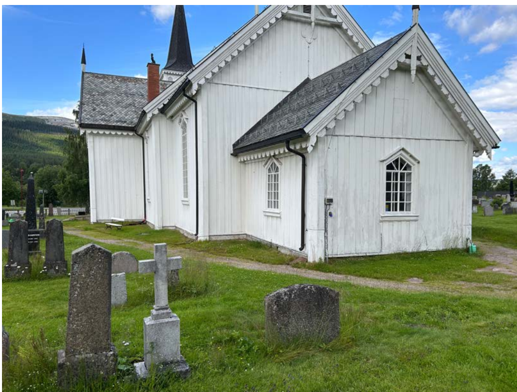
Østvegg sakristi. Drenskum til høyre for sittebenk. Vannpost på vegg i høyre billedkant.
