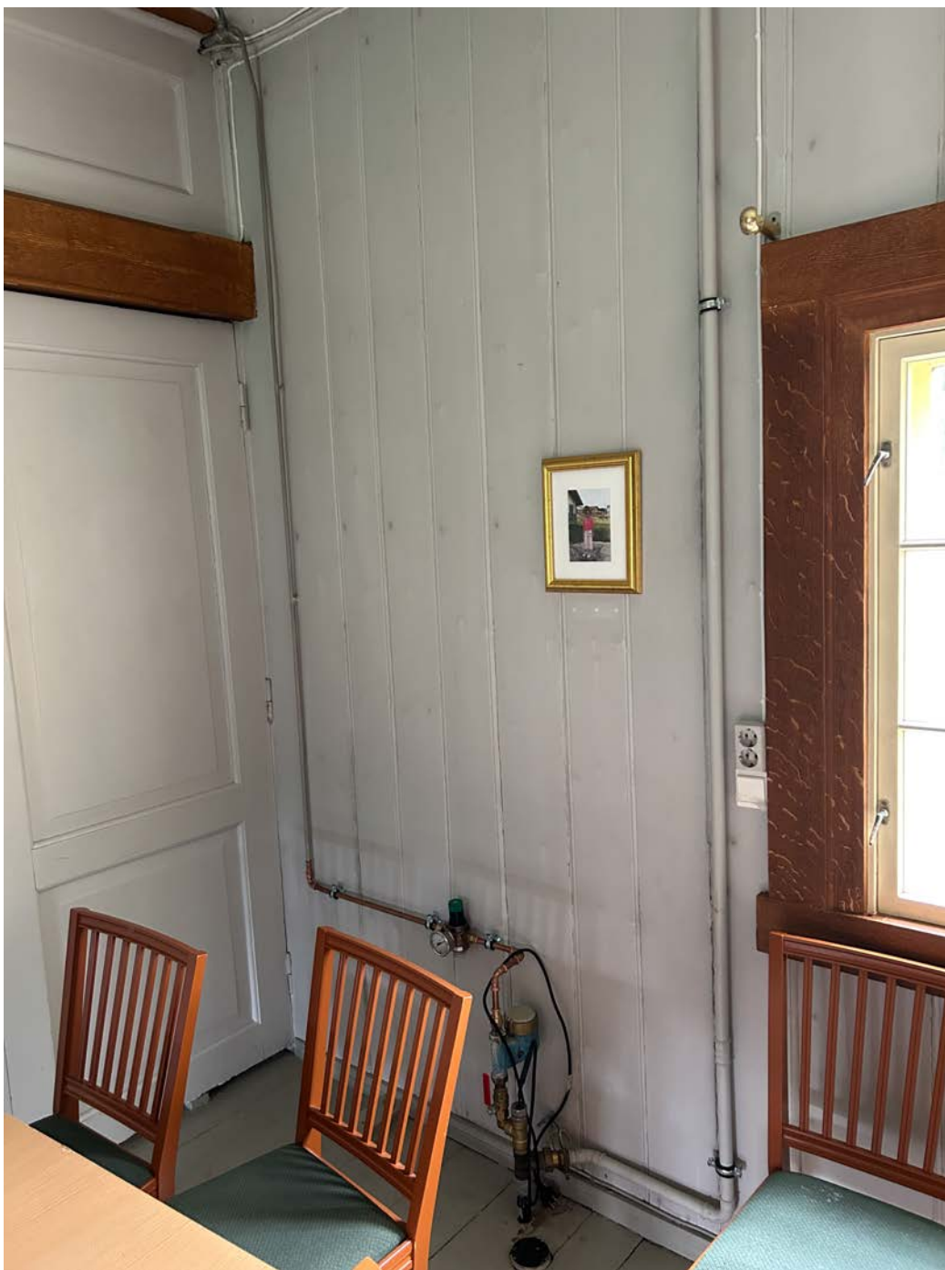
Inntak vann i menighetssal, vannmåler og avgrening til hhv. sakristi og sprinkleranlegg.
