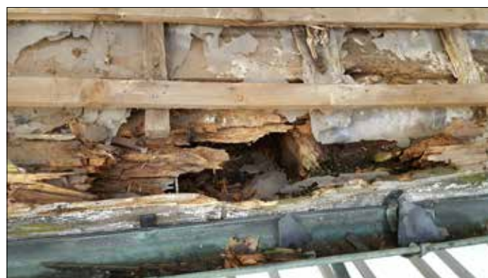
Bildene viser store skader på taket. Foto: Willy Finnbakk
