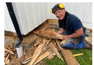
Finn Rune Stabell viser at bunnsvill har råtne opp.
