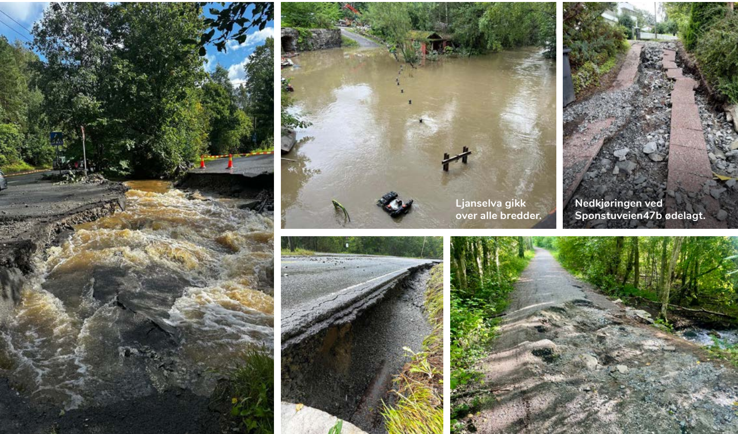
Veien til Bjørnerud ødelagt.
