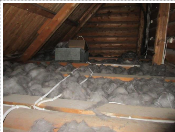
Bilde nr. 20 Gammel glassvatt i etasjeskille mot kaldloft. Her ses nyere el-føringsrør.
