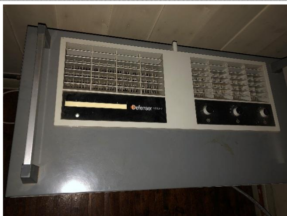
Bilde nr. 33 Utskifting av luftfukter medtas som et moderniseringstiltak.
