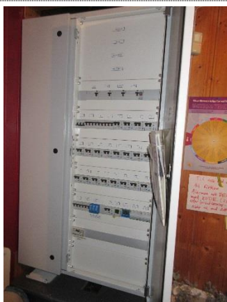
Bilde nr. 39 Nytt fordelerskap fra 2015 plassert i «teknisk rom».
