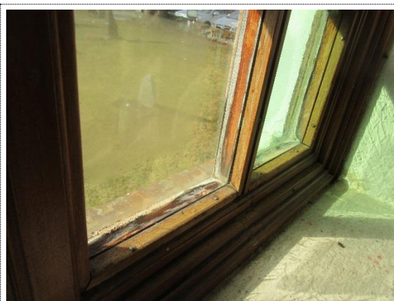
Bilde nr. 20 Oljede vinduer i skipet.
