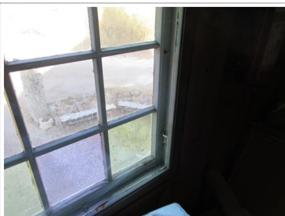
Bilde nr. 19 Malt trevindu i våpenhuset.
