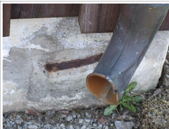
Bilde nr. 2 Taknedløpene bidrar til at vann legger seg inntil ytterveggene.
