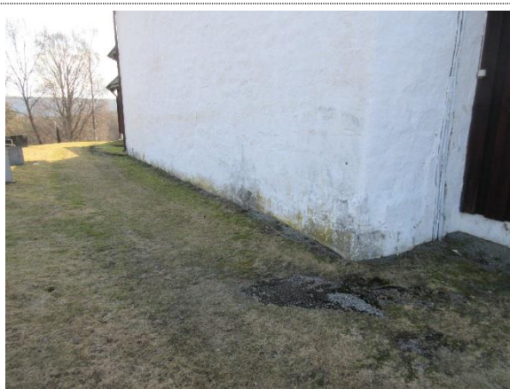
Bilde nr. 1 Ytterveggene viser tegn på fuktoppsug noen steder.
