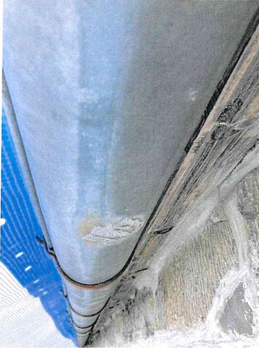
Bilde viser takrenne som er fuget igjen da det er korrodert hull i rennen.
