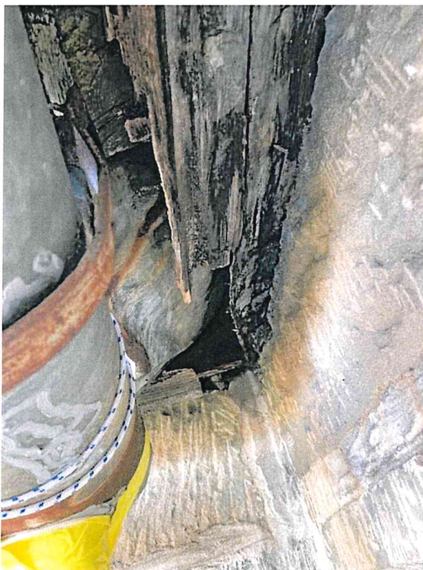
Bildet viser kilrenne på hovedskipet der treverket er råtnet bort.
