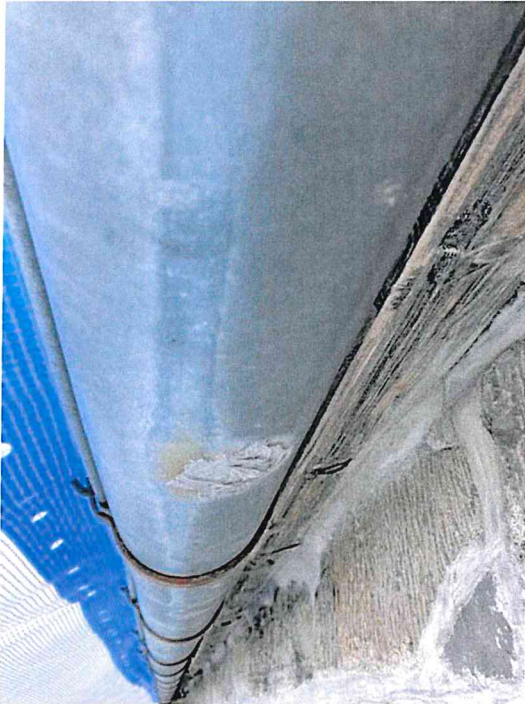
Bilde viser takrenne som er fuget igjen da det er korrodert hull i rennen.
