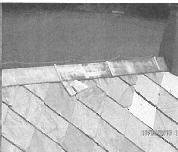
Figur 17. Skader i skiferstein (ikke fare for nedfall, men bør festes).
