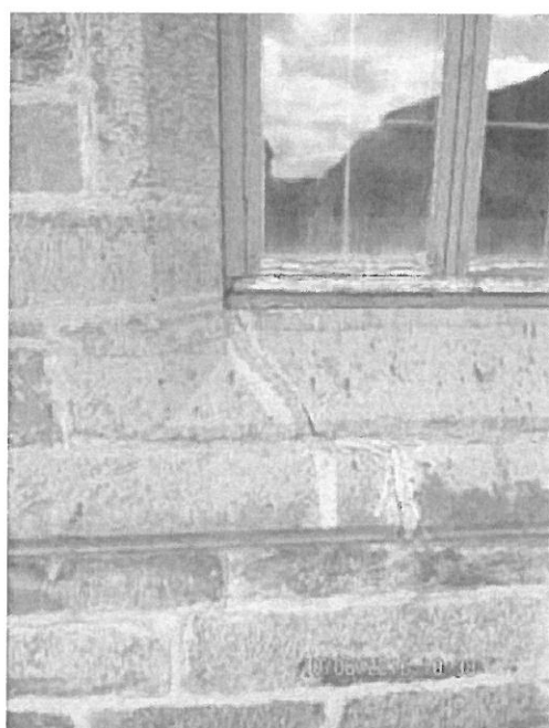
Figur 12. Malingsslitt vindusinramming (riss i sålbenk).
