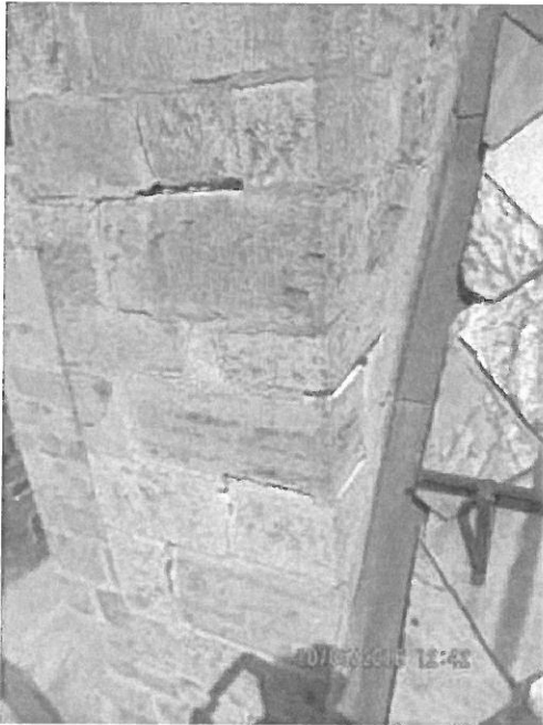
Figur 26. Beslag mellom vegg og takflate er mangelfullt utført, og bør utbedres samtidig som det gjøres tiltak på tak mot syd.
