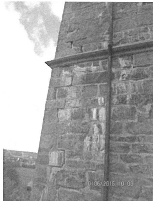
Figur 3. Parti med skader, sydside tårn
