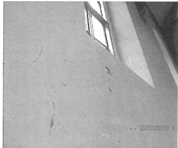
Figur 19. Fukt- og saltrelaterte skader på sydvegg.
