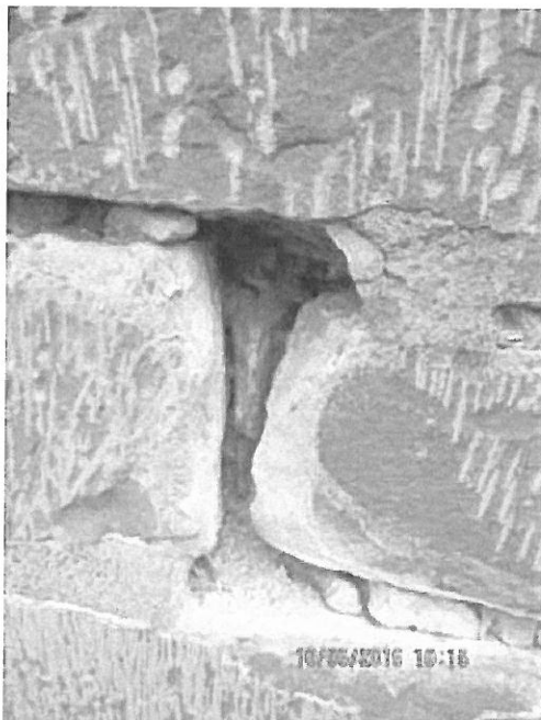
Figur 4. Eksempel på skade, utfall av fuger.
