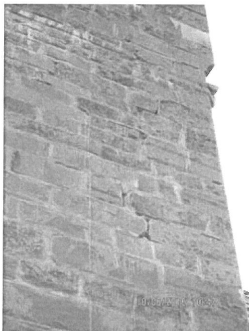
Figur 8. Skader på tverrskipets sydvegg.
