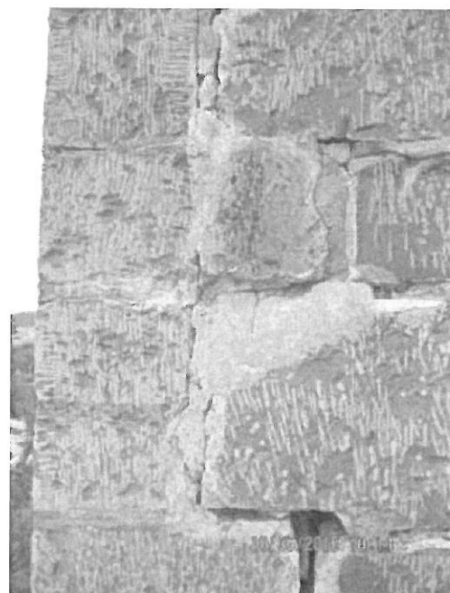
Figur 5. Riss og utfall av fuger.
