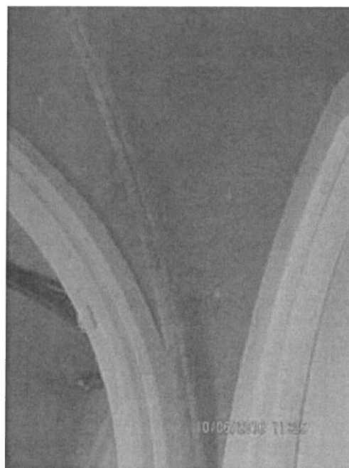
Figur 15. Aktiv lekkasje fra takvindu gir skader i korhimling mot nordvest.
