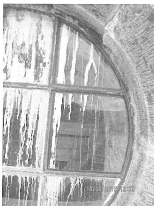
Figur 13. Korrosjon på støpejernsvindu. (Kalkutfellinger på glass.)
