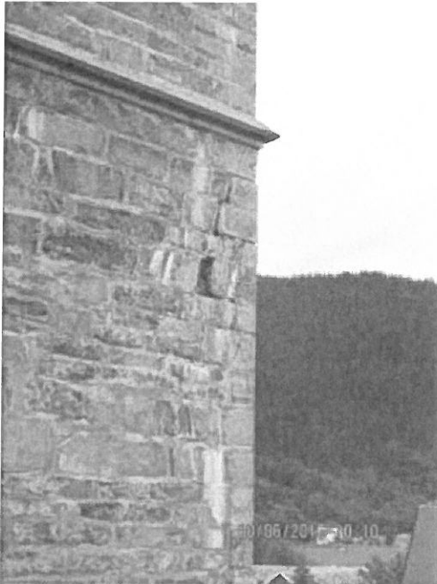
Figur 2. Parti med skader, vestside tårn
