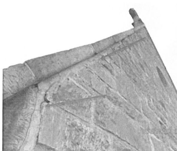
Figur 9. Riss nedover langs gavl på tverrskipets sydvegg.
