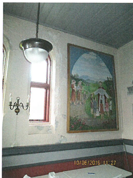
Figur 23. Fukt- og saltrelaterte skader i sakristi (østvegg).
