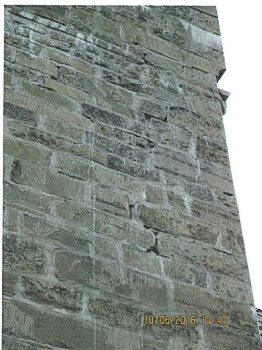
Figur 8. Skader på tverrskipets sydvegg.
