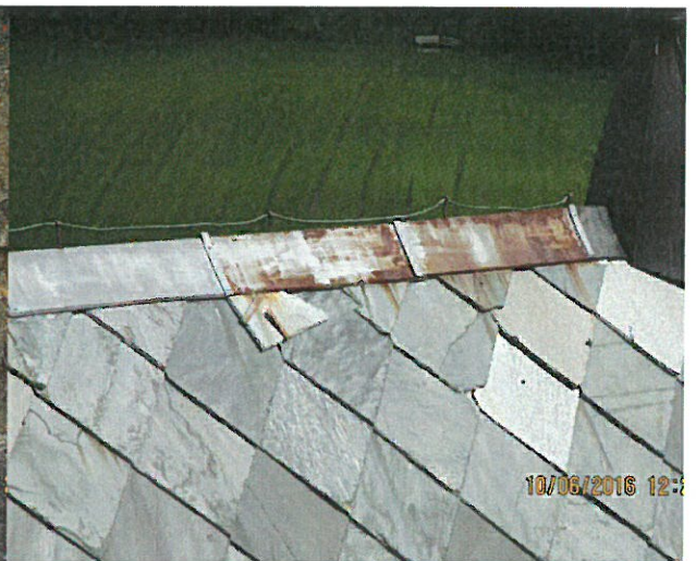
Figur 17. Skader i skiferstein (ikke fare for nedfall, men bør festes).
