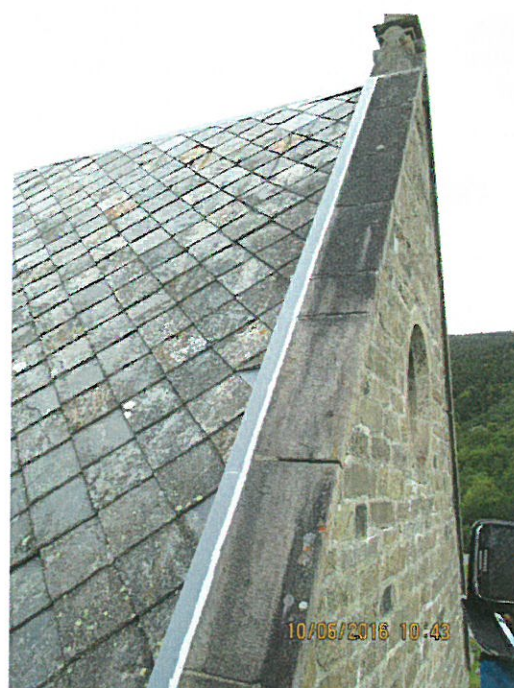
Figur 7. Gavlen på tverrskipets sydvegg har utfall i fuger. Tidligere montert beslag har blåst av.
