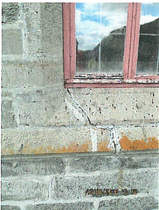
Figur 12. Malingslitt vindusinnramming (riss i sålbenk).
