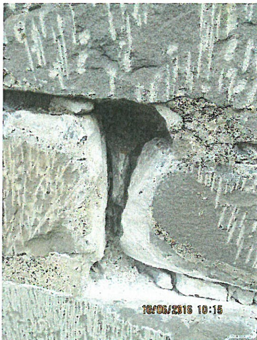
Figur 4. Eksempel på skade, utfall av fuger.
