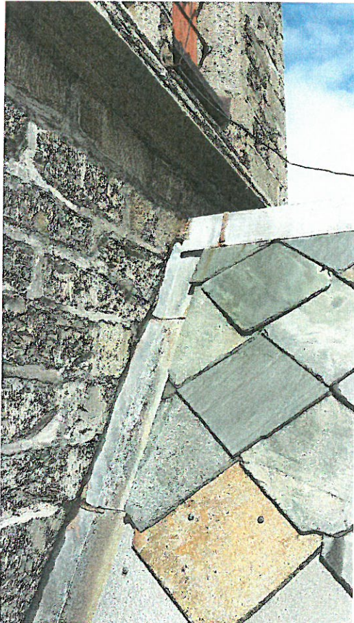
Fig 28: En takstein er i ferd med å løsne, og En takstein er skrudd fast med skruer midt i steinen.
