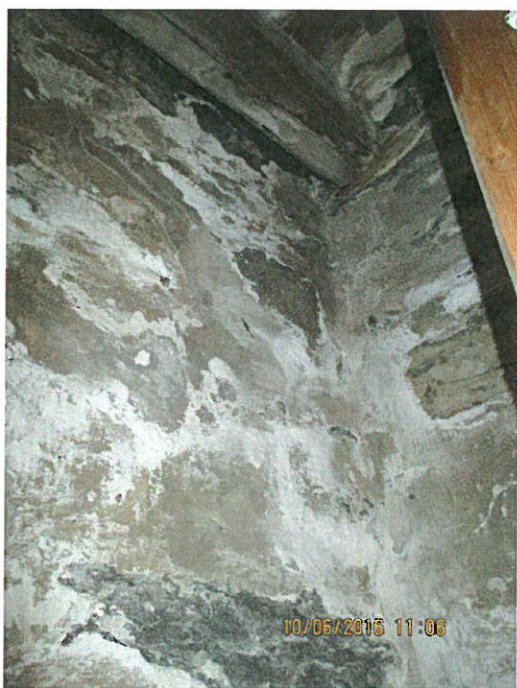
Figur 24. Fukt- og saltutslag i tårn.
