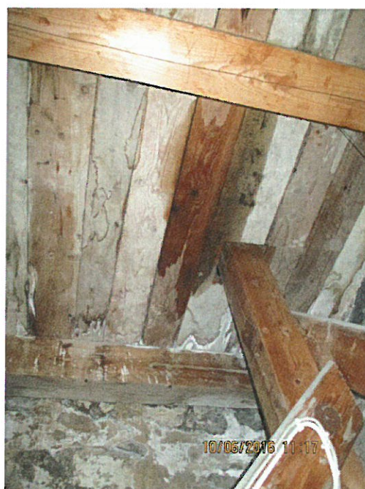
Figur 25. Lekkasje i tårn, som høyst sannsynlig skyldes at regnvann kommer inn gjennom treskoddene i toppen av tårnet.
