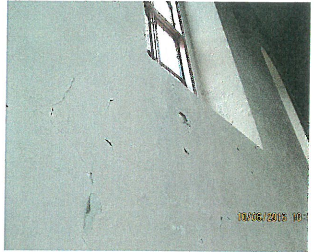
Figur 19. Fukt- og saltrelaterte skader på sydvegg.
