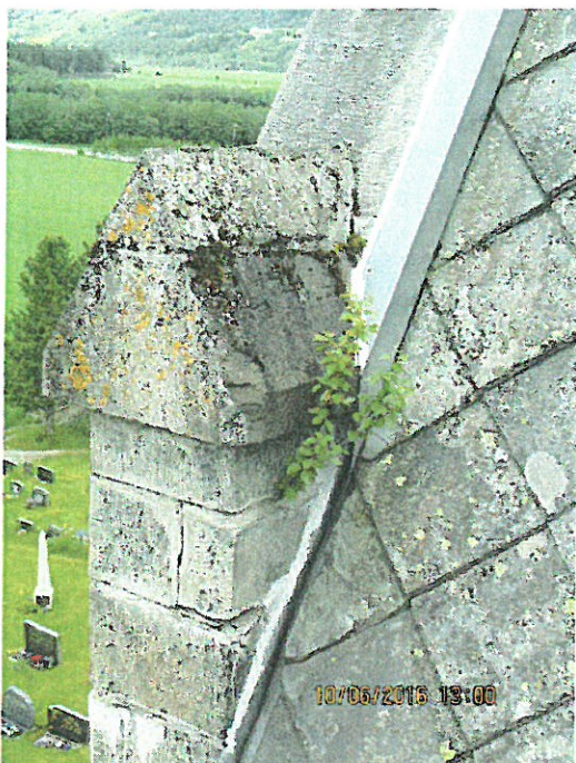
Figur 10. Begroing bør fjernes.
