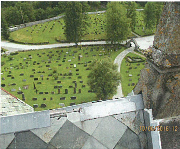
Figur 16. Skader i beslag på tak (tverrskip mot syd).
