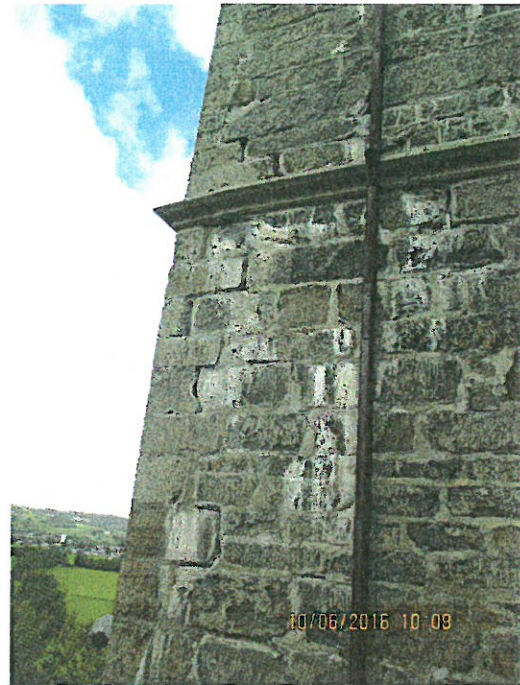
Figur 3. Parti med skader, sydside tårn
