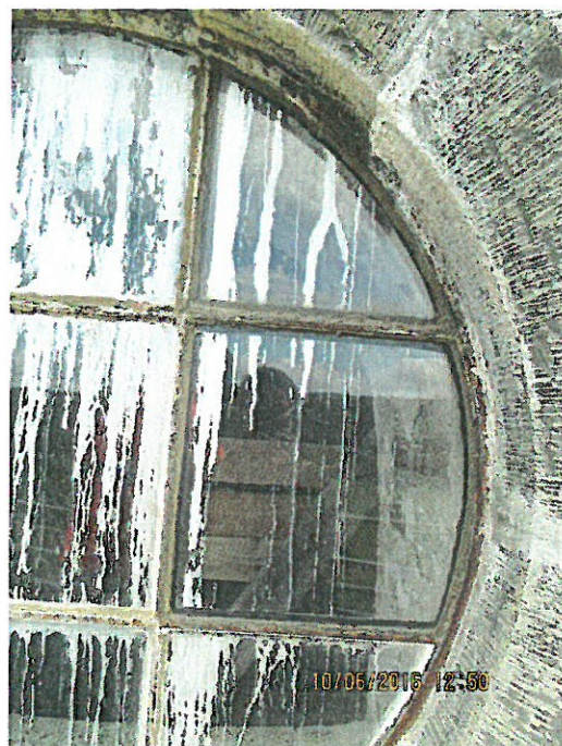
Figur 13. Korrosjon på støpejernsvindu. (Kalkutfelling på glass.)
