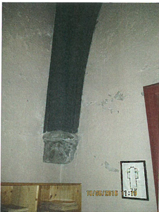
Figur 22. Fukt- og saltrelaterte skader på galleri.
