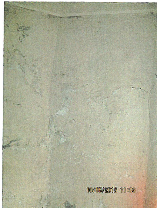
Figur 21. Fukt- og saltrelaterte skader under galleri.
