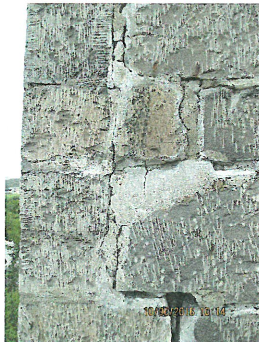
Figur 5. Riss og utfall av fuger.
