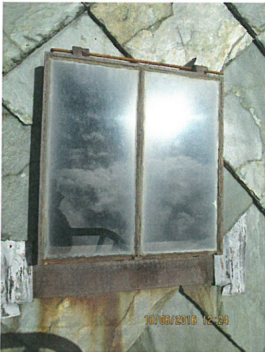
Figur 14. Opprinnelig takvindu i støpejern. Lekkasje ned til himling i kor.
