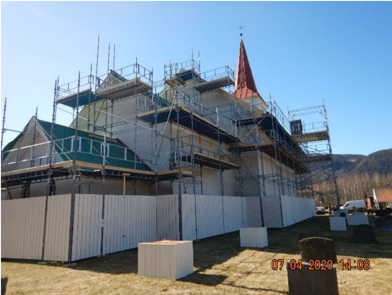
Det er benyttet frittstående stålstillas uten forankring i veggene. Stillaset har i tillegg vært innplanket for å hindre adkomst og øke sikkerheten under gjennomføringen.
