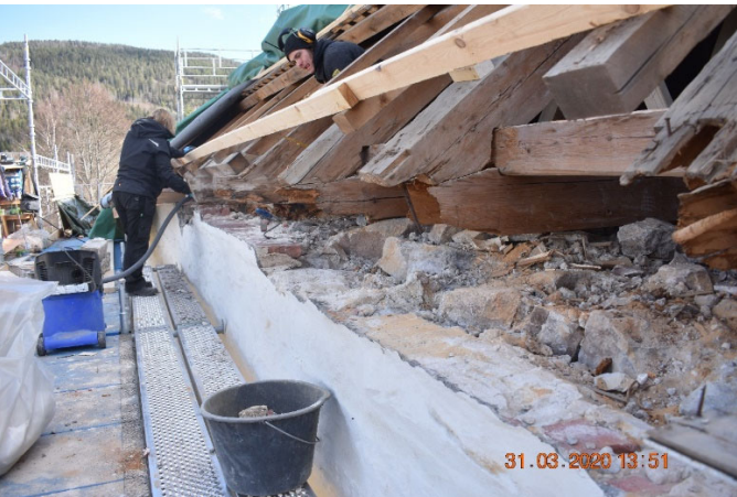
Skadeomfanget i takstolens opplegg på murveggene var betydelig. Murremmer var stedvis forsvunnet. Her pågår rengjøring og rens av skadesone, og klargjøring for kjemibehandling.
