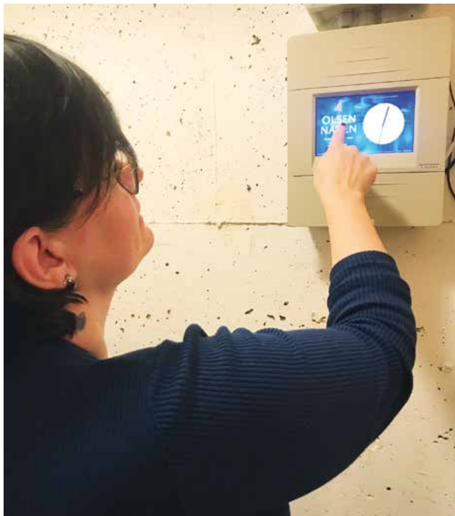
Kirketjener Lindi Anna Aagedal frykter ikke lenger ukontrollert ringing fra kirkeklokkene i Grim kirke. Her viser hun det nye betjeningsanlegget som er installert.
