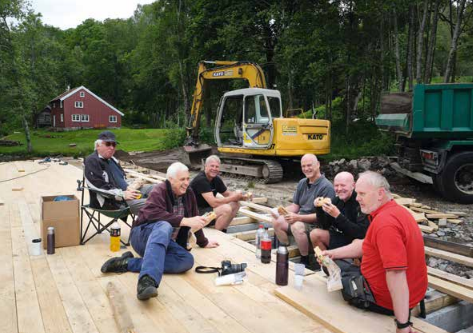
Mange i Tveit har bidratt i dugnadsarbeidet med å restaurere brygga på Knarestad. Da Bladet Vårt var innom traff vi på fra venstre: Nils Tvedt, Trygve E. Tønnesen, Arne Kristensen (gravemaskinfører), Birger Tvedt, Arne Kjell Nyhagen og Svein Skuland, som her tar seg en velfortjent matpause.
