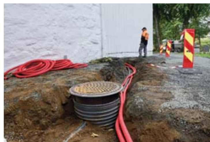
I grøfta her går strøm og vann til de store pumpene inne under trappa i våpenhuset.
