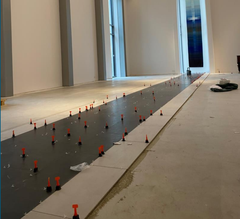
Arbeidet med Saku kirke går stadig framover. Her legges det gulv inne i kirken. Foto: Magne Mølster
