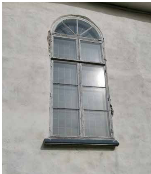
HURUM: Vinduene på Hurum krike er tørre, og veggen rundt har skader. Veggene og vinduene blir restaurert neste år og er en av årsakene til at kirka holdes stengt store deler av året. Foto: Asker kirkelige fellesråd / Haandverkerne
