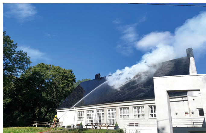
Brannen 13. september i fjor, ble raskt slukket av brannvesenet, og medførte kun materielle skader.
